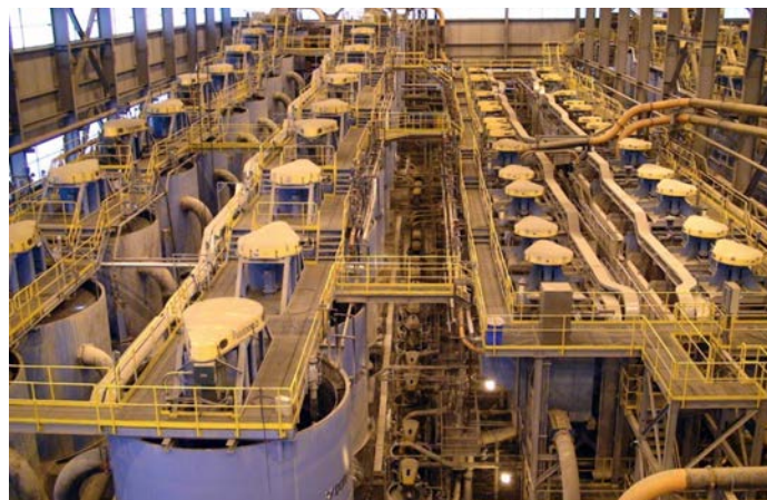
Planta de flotación
